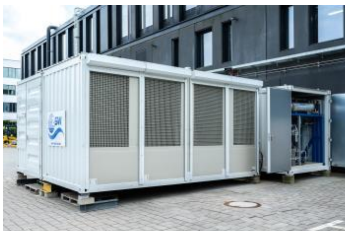
Außenansicht der DAC-Anlage mit CO 2 -Absorber (vorne) und CO 2 -Desorber (hinten)
