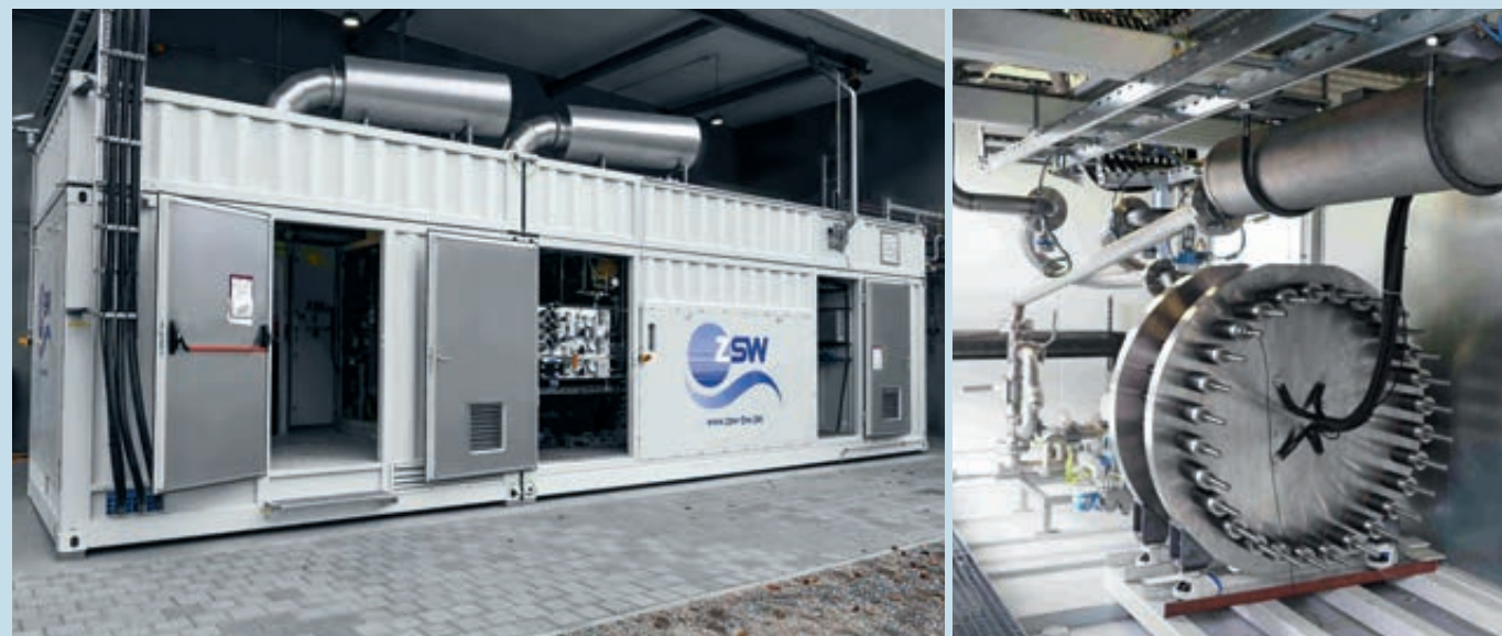
// Forschungsplattform (links) und Elektrolyseblock (rechts) des ZSW an der Power-to-Gas Anlage in Wyhlen. // ZSW Research platform (left) and electrolysis block (right) at the Power-to-Gas plant in Wyhlen.
