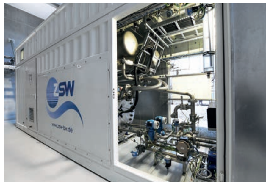
// Containerbasierte F&E-Elektrolyseeinheit an der Power-to-Gas-Anlage in Wyhlen.
