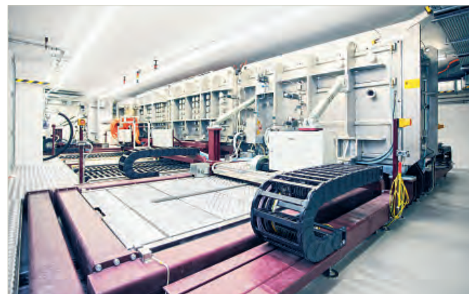
// Rolle-zu-Rolle-Anlage zur Beschichtung von flexiblen Substraten. // Roll-to-roll plant for coating flexible substrates.
