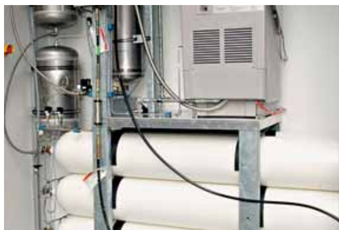
// Druckspeicher für Erdgasbetankung // Pressure accumulator for refuelling with natural gas
